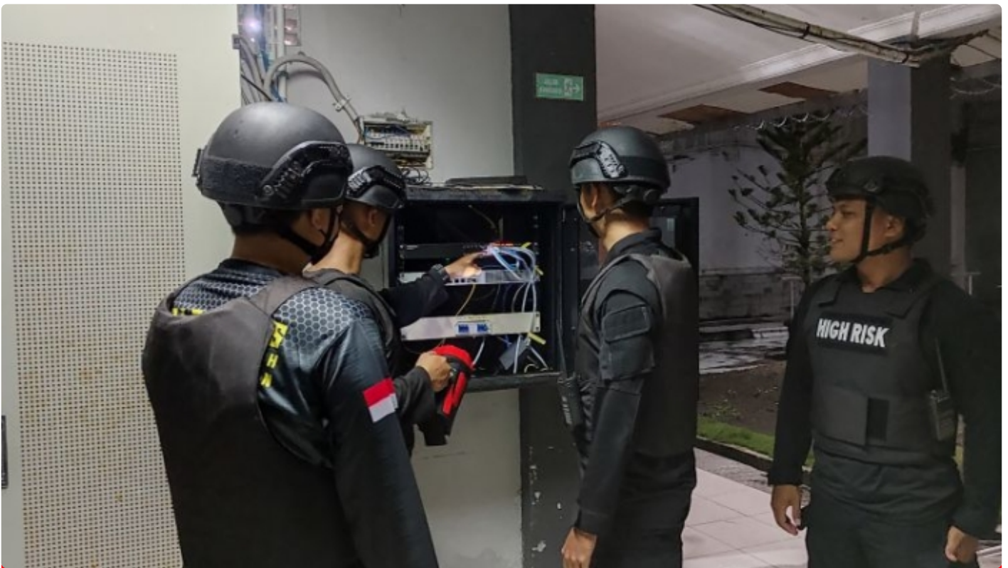
Petugas melakukan pengecekan secara rutin terhadap instalasi jaringan listrik dan CCTV
